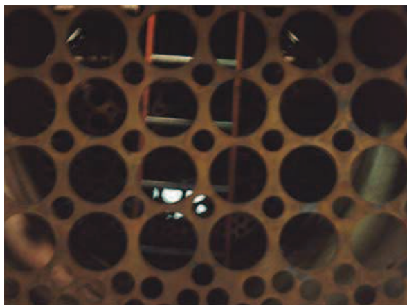
So zeigt sich ein Kessel „ohne Rohre“
